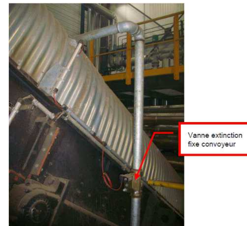
FIGURE 5 : CENTRALE BIOMASSE SPE SDL ACTUELLE – VANNE EXTINCTION EN PLACE SUR LE CONVOYEUR
